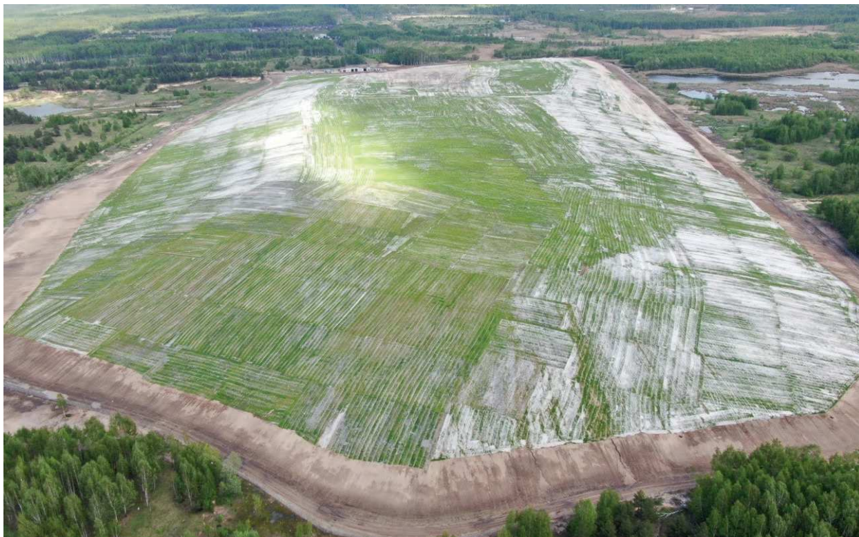
Фото 3.2.6-9. Вид полигона «Игумново» на 25 мая 2020 г. [196, с. 491]
